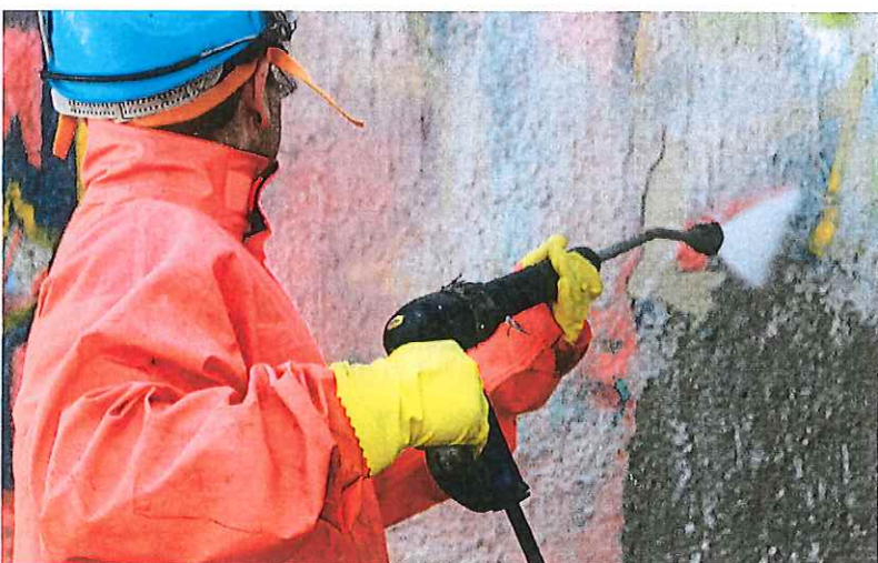
OBEN: Beispiel einer Graffiti-entfernung von einer Klinkerfassade: So sah es vorher aus, ...
